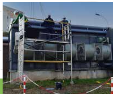
Batterie de suppression de panache
