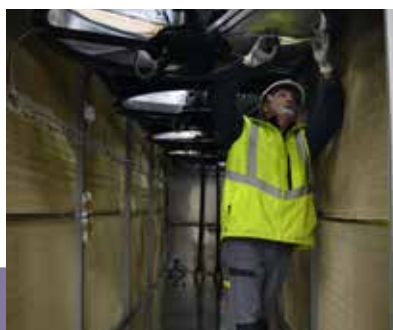
Contrôle des Ventilateurs
