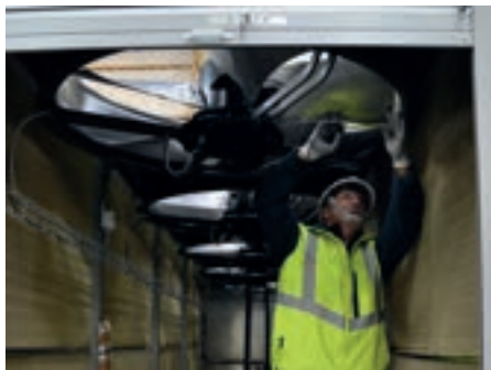
Contrôle des ventilateurs
